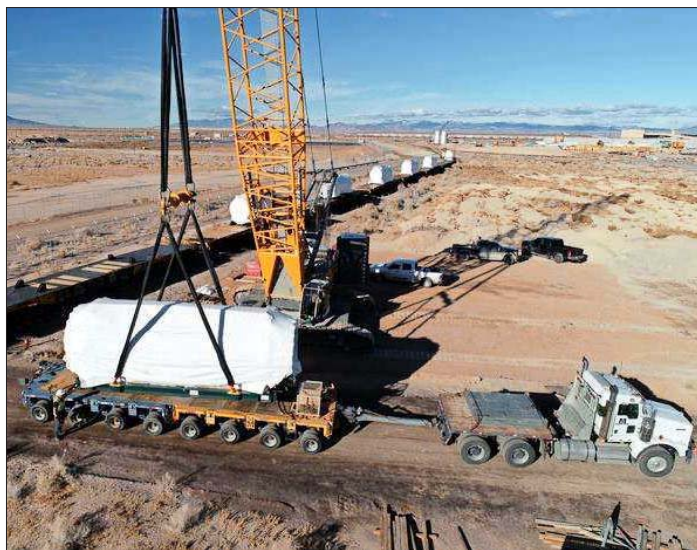
Un electrolizador se encuentra en la plataforma de un camión en el proyecto de Almacenamiento Avanzado de Energía Limpia que se está construyendo en Delta, Utah.
