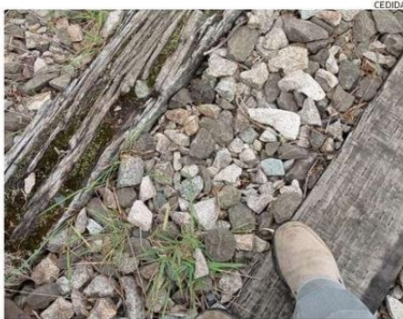
EN MALAS CONDICIONES ESTÁN LOS DURMIENTES.
