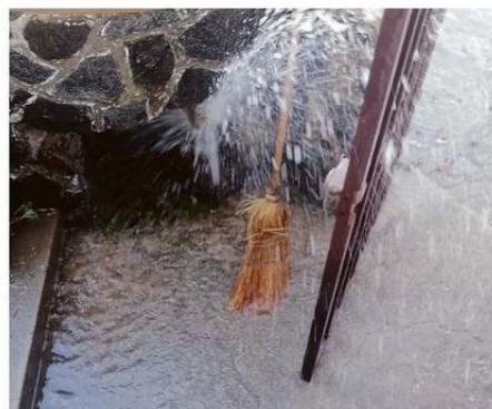
FUGA DE AGUA EN EL CENTRO MÉDICO DE VIÑA DEL MAR.
