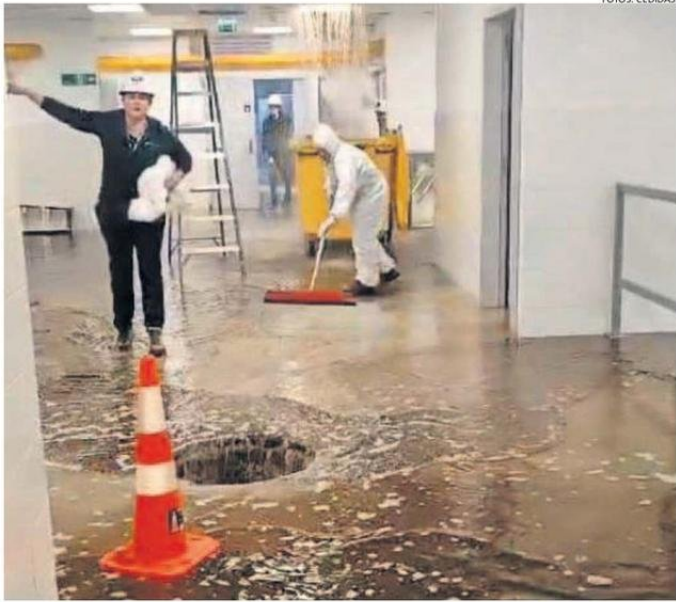
AGUA AFECTÓ EL PISO SUBTERRÁNEO DEL EDIFICIO, DONDE SE ENCUENTRA SERVICIOS GENERALES.
