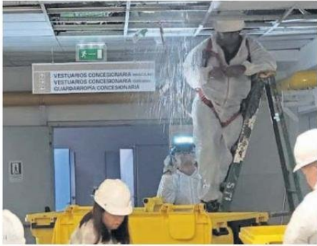
FUNCIONARIOS DEL HRA MITIGANDO LA FUGA.
