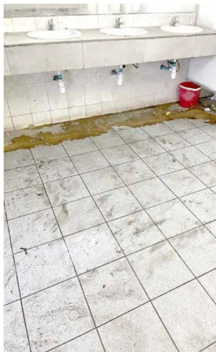
Los servicios higiénicos del Liceo Zapallar muy afectados con las recientes precipitaciones.
