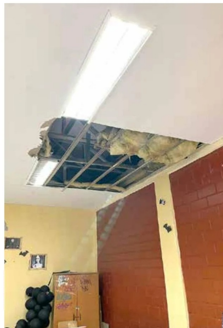
Los cielos de las salas de clase también sufrieron daños.
