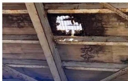
INCREÍBLE. ASÍ SE VE EL PUENTE EDUARDO FREI DE CARAHUE POR DEBAJO, QUEDANDO CLARO QUE SE REQUIERE DE REPARACIONES URGENTES.
