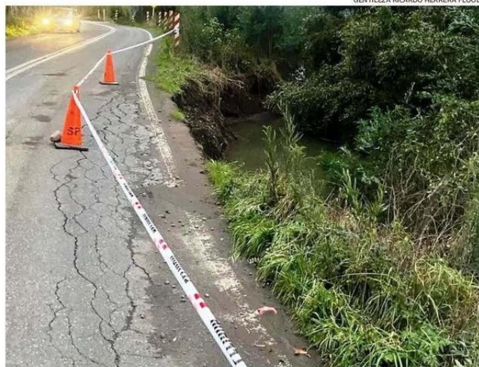
EL SOCAVÓN SIGUE CRECIENDO, CAUSANDO SERIOS PROBLEMAS EN EL TRÁNSITO POR ESTA RUTA COSTERA.
