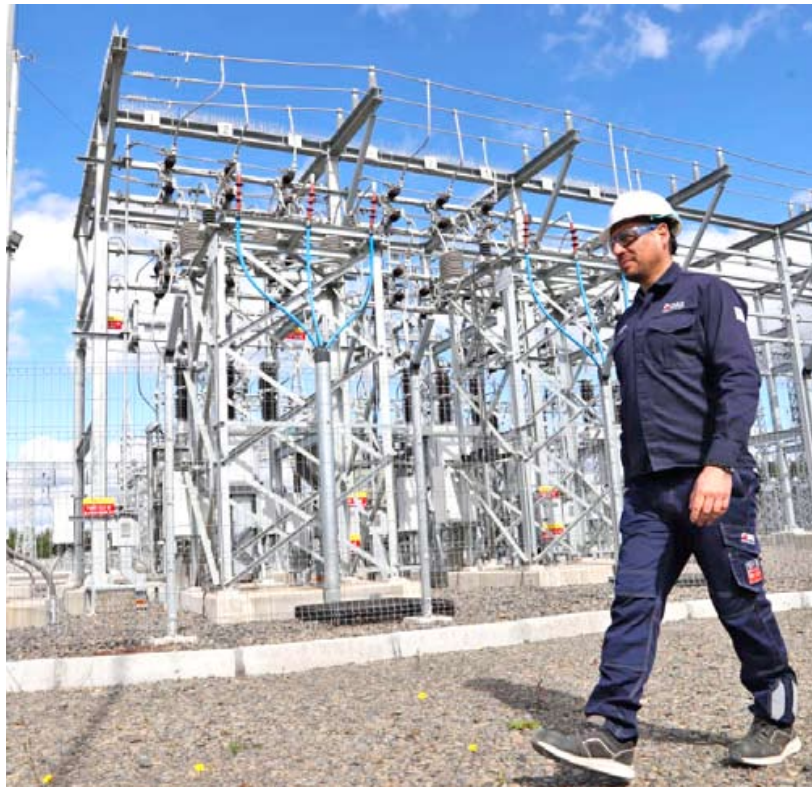
Ambas obras contribuirán a darle mayor resiliencia al sistema energético regional.
