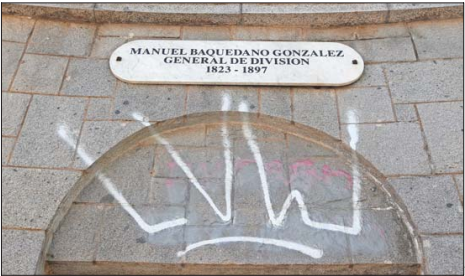
ROBOS.— Entre los distintos actos de vandalismo que han afectado a la estructura está el robo de elementos y placas de mármol.
