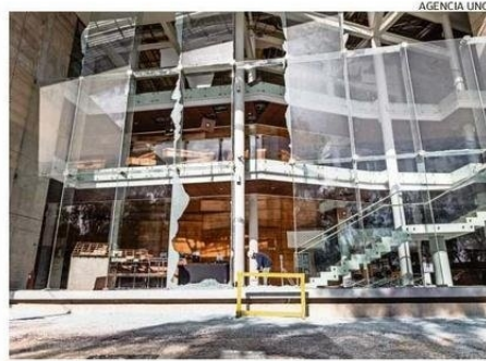
TRAS EL TEMBLOR VARIOS EDIFICIOS QUEDARON DAÑADOS.
