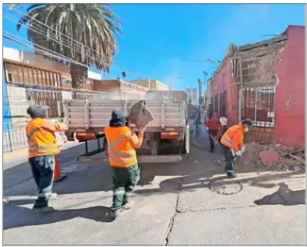
COPIAPÓ.— Han continuado los trabajos de limpieza y despeje de las vías tras el intenso sismo.
