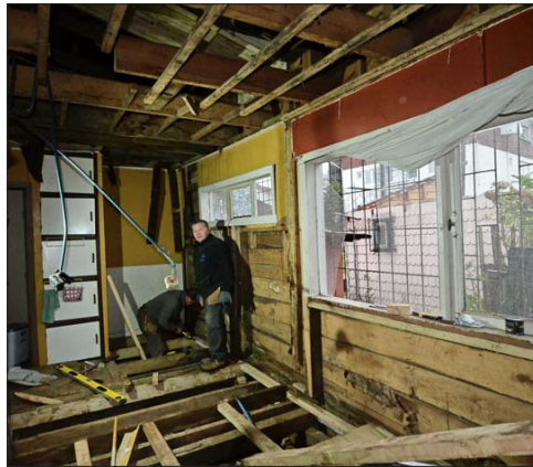
DESTRUCCIONES. — Esta casa está siendo reparada por sus dueños. Muchos vecinos aprovechan bonos entre $350 mil y $1,5 millones.
