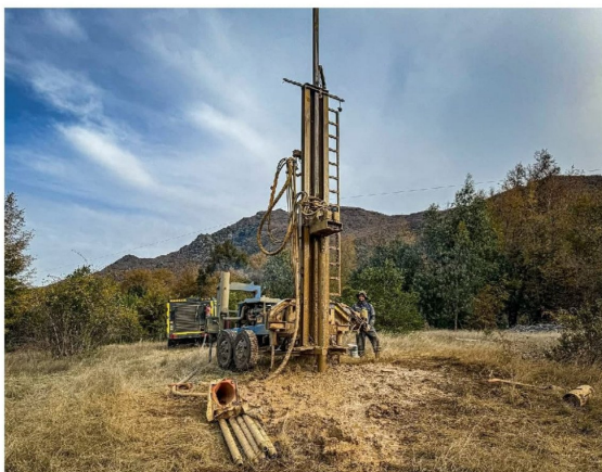
LOS POZOS ALCANZAN entre 35 y 70 metros de profundidad y están equipados con bombas sumergibles y sistemas de cloración.
