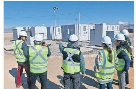
EL ALMACENAMIENTO ACTUAL CONSISTE EN 24 CONTAINERS DE BATERÍAS
