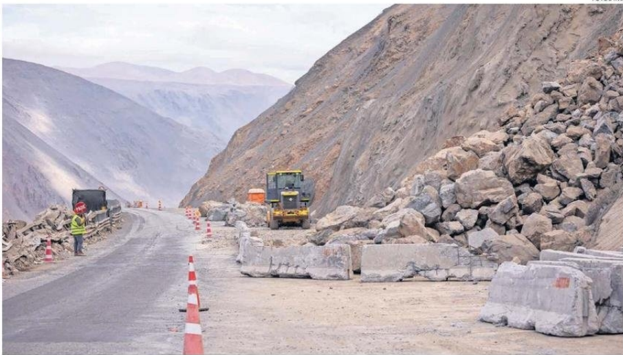
A 10 MESES DEL COLAPSO QUE MANTUVO VARIOS DÍAS CORTADO EL ACCESO EN EL LUGAR, PREOCUPA EL LENTO AVANCE EN LAS LABORES.
