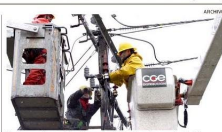
La comuna ha registrado constantes cortes de energía eléctrica.
