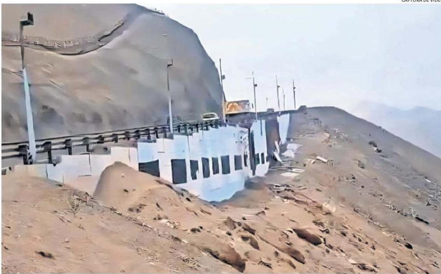
DESDE OBRAS PÚBLICAS SEÑALAN QUE ESTÁN TRABAJANDO EN PROYECTO PARA MEJORAR TRAMO DEL MURO DETERIORADO.
