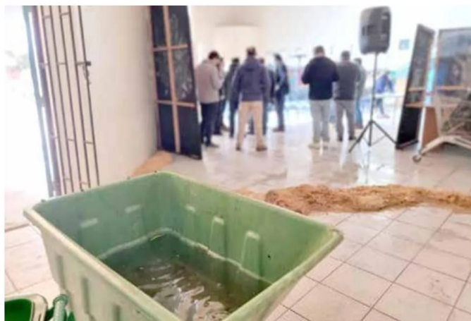
El Liceo Bicentenario Zapallar fue uno de los establecimientos afectados en 2023 y que con las lluvias de este año, quedó en evidencia la necesidad de reparaciones.
