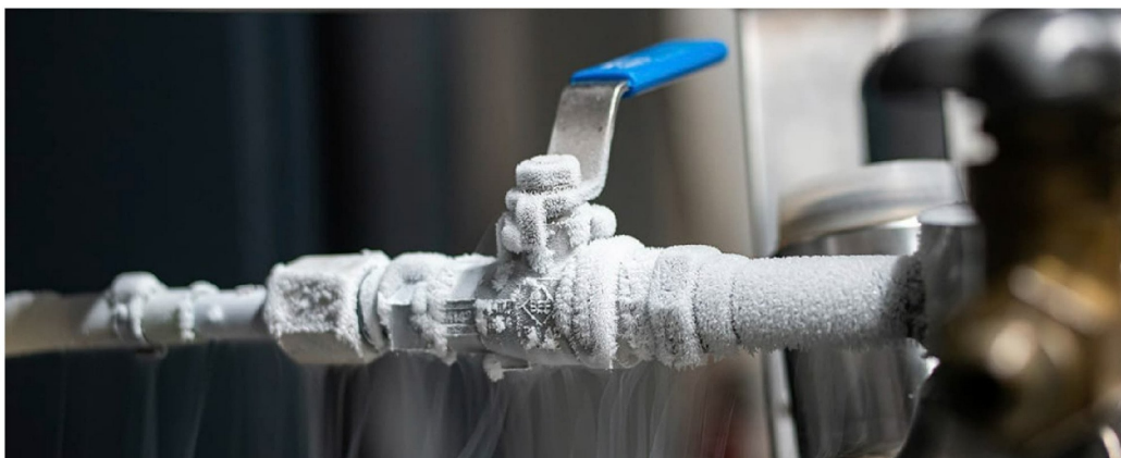
ESPECIALISTA ADVIERTE que las cañerías requieren recubrimientos aislantes desde su instalación para evitar rupturas.
