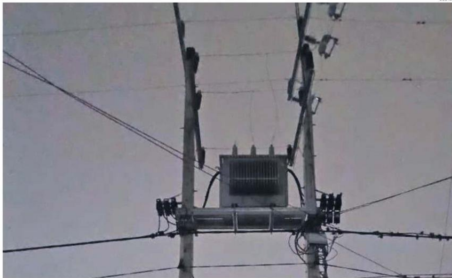
ASEGURAN QUE LAS LUMINARIAS QUE ESTÁN TAMPOCO FUNCIONAN CORRECTAMENTE
