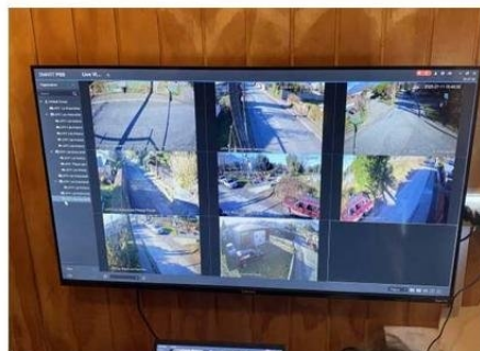
TAMBIÉN SE IMPLEMENTÓ UNA SALA DE VIGILANCIA ADMINISTRADA POR LOS MISMOS VECINOS.
