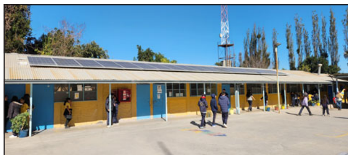
Estos son los paneles instalados en la Escuela San José.
