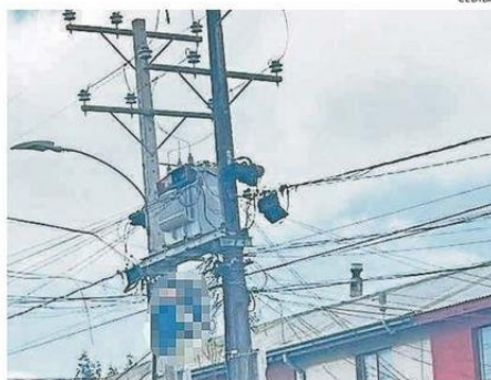
EN ESTE TENDIDO ELÉCTRICO DE BOCA SUR OCURRIÓ EL HECHO.
