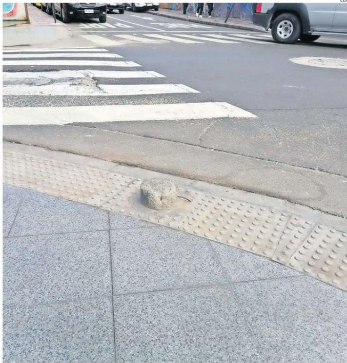
LO QUE QUEDA DE UNO DE LOS SEGREGADORES ES UN RIESGO DE TROIEZO JUSTO AL CRUZAR.
