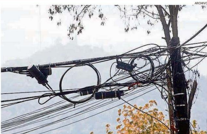
EL ROBO DE CABLES HA AUMENTADO CASI UN 300% EN COMPARACIÓN CON EL MISMO PERIODO DE 2024.
