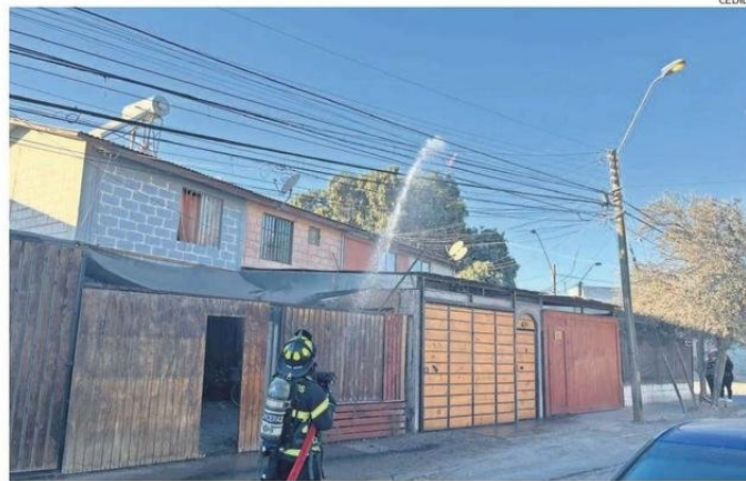
LOS CABLES EN LLAMAS FUERON ADVERTIDOS POR LOS VECINOS DEL SECTOR QUE ALERTARON A BOMBEROS.
