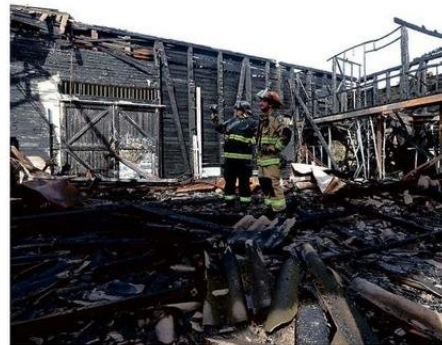
FUEGO CAUSÓ GRAVES DAÑOS EN EL RECINTO DE LLOLEO.
