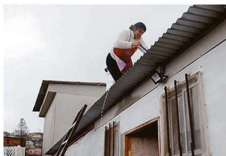
CINCO VIVIENDAS FUERON AFECTADAS POR FILTRACIONES EN LA ZONA DEL 2-F.
