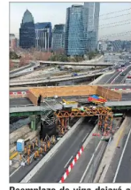
REEMPLAZO DE VIGA DEJARÁ AL PUENTE LO SALDES (VITACURA) TOTALMENTE CERRADO HASTA EL 23 DE AGOSTO. | C 7
