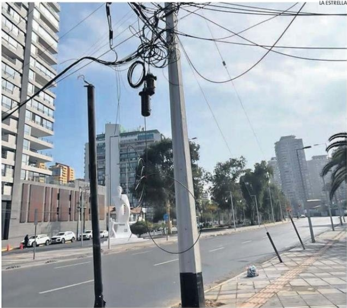
EL POSTE YA REPUESTO LA MAÑANA DE AYER, SIN EMBARGO AÚN FALTA EL SEMÁFORO EN EL LUGAR.
