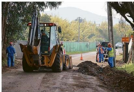
EL DERRAME OCURRIÓ EN UN PREDIO COLINDANTE A LA RUTA F-232.
