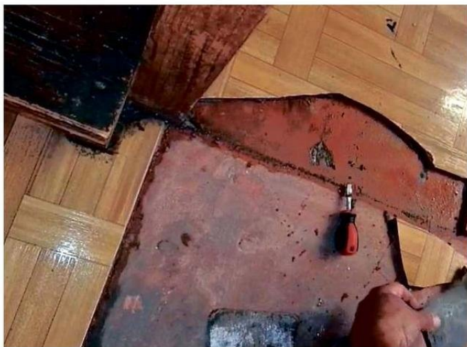
UN VECINO ROMPE LAS BALDOSAS DEL PISO QUE FILTRA EL AGUA ACUMULADA POR AÑOS DE FALLAS.
