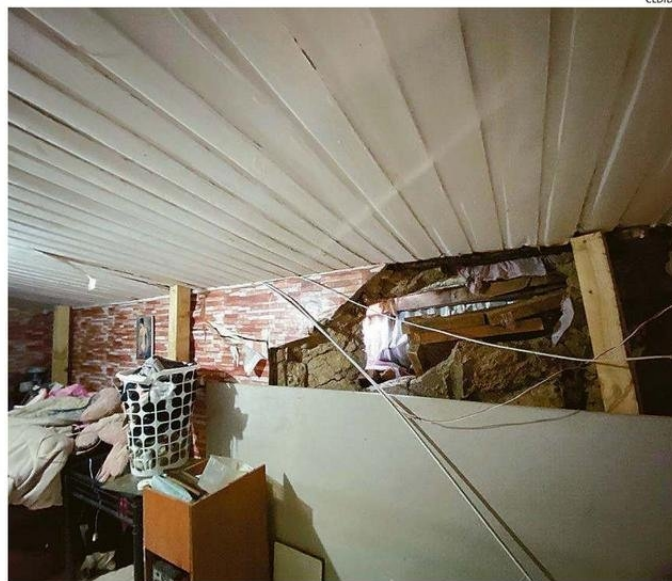
EN ESTAS CONDICIONES QUEDÓ UNO DE LOS DORMITORIOS DE MARGARITA Y SU FAMILIA.
