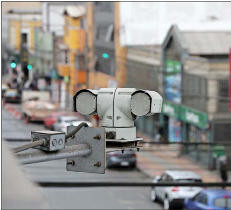
RESGUARDO. — En diversas zonas del país es habitual que locatarios denuncien que los afecta una ola de robos y por ello han apostado a la instalación de cámaras.
