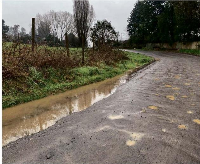
EL DETERIORO DEL CAMINO ES EVIDENTE Y SE INTENSIFICA MÁS EN LOS DÍAS DE LLUVIA.
