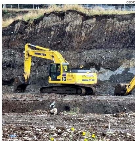
SMA CONFIRMÓ REALIZACIÓN DE TRABAJOS SIN PERMISO EN HUMEDAL.
