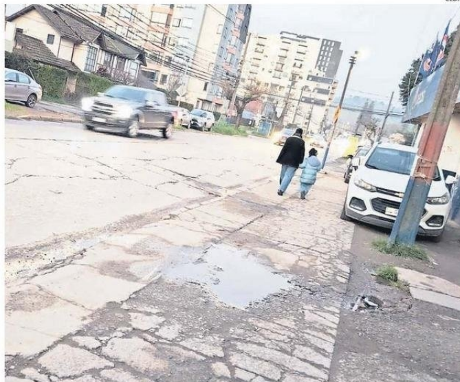
EL TRÁNSITO PEATONAL SE VUELVE ESPECIALMENTE DIFÍCIL POR LA VEREDA DE LA AVENIDA COLLAO.
