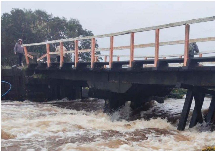
EL FUERTE CAUDAL CAUSÓ DAÑOS EN EL PUENTE LA POZA UNO, EN LA COMUNA DE HUALAIHUÉ, ESPECÍFICAMENTE EN LA RUTA COSTERA.
