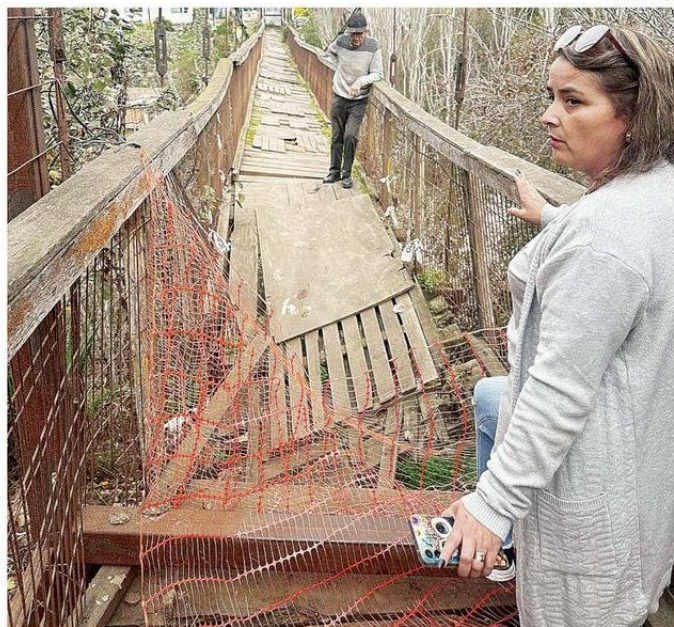
A FINES DE JULIO UN TRAMO DEL PUENTE COLAPSO.
