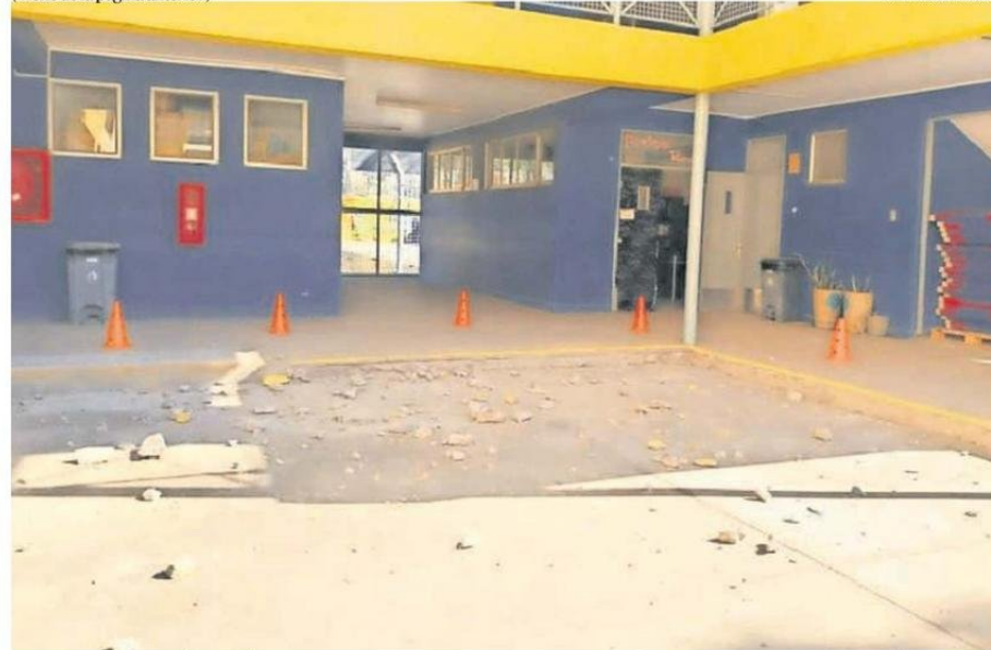
EL SISMO DE JUNIO TAMBIÉN HABRÍA INFLUIDO EN AUMENTO DE INASISTENCIA, DEJANDO DAÑOS EN VARIOS RECINTOS DE EDUCACIÓN.
