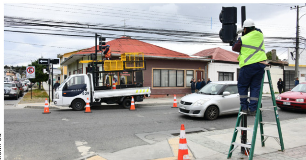
Municipio asegura mantención de semáforos en Punta Arenas.
