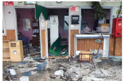
PARTE DE LA DESTRUCCIÓN QUE DEJÓ EL FUEGO Y EL AGUA DE BOMBEROS.
