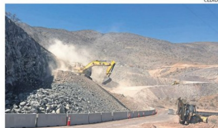
LO DE LA GRIETA ES UN PANORAMA QUE CON EL TIEMPO SE ACENTÚA.
