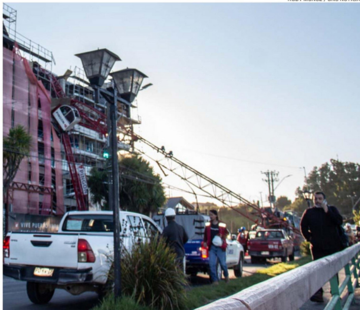
AUTORIDADES Y REPRESENTANTES DE DIVERSOS SERVICIOS EVALÚAN EL DESPLOME DE LA GRÚA PLUMA.
