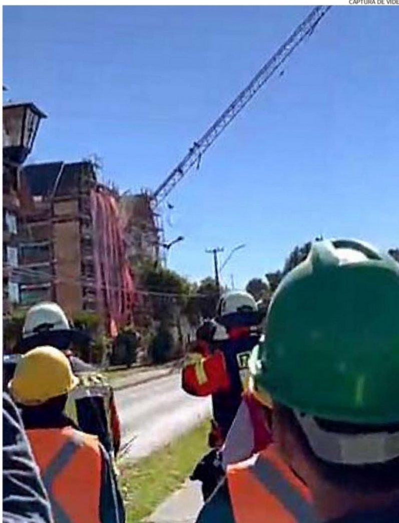
EL MOMENTO EXACTO DEL DESPLOME EN LA COSTANERA DE PUERTO VARAS: PARTE DE LA GRÚA CAYÓ AL LAGO.
