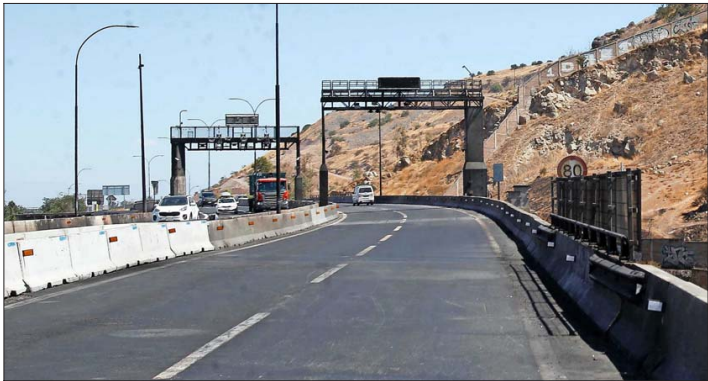
CARRETERA.—Según informó la Municipalidad de Renca, la autopista no tiene daño estructural tras el estallido. La intersección de la Ruta 5 con General Velásquez se encuentra operativa.
