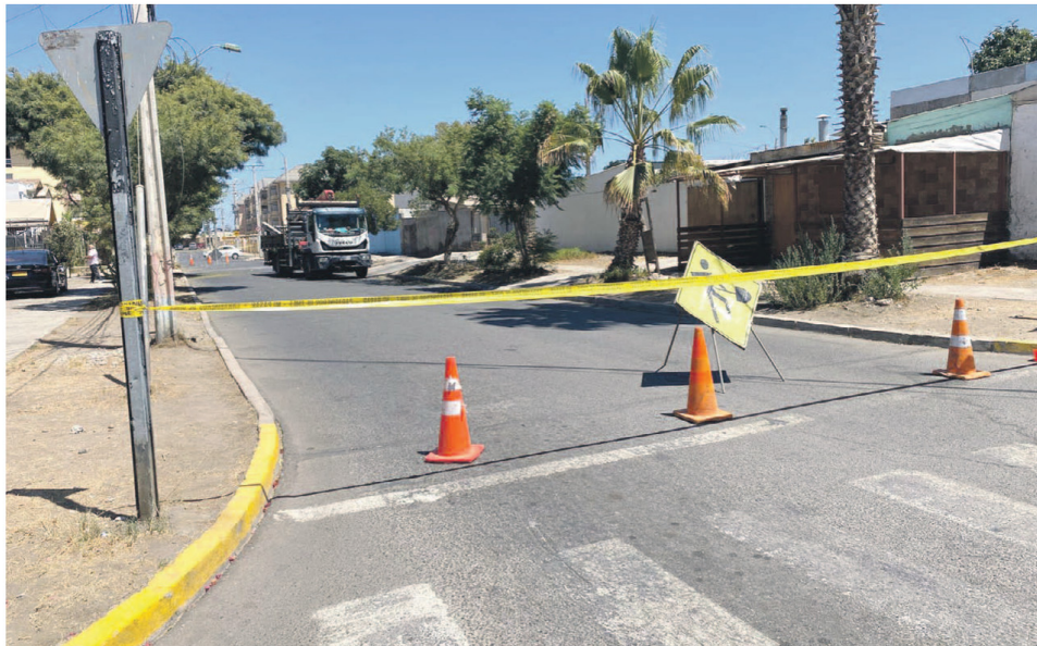
Brigadas de CGE trabajaron durante la mañana en la reposición de dos postes quebrados y cables dañados en el sector El Molino.
