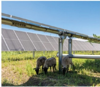
→ Planta solar fotovoltaica Gran Teno de Grenergy, región del Maule.
