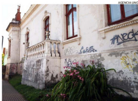
LOS MUROS ESTÁN DESGASTADOS, CON HONGOS Y RAYADOS.
