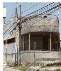
OBRAS ESTÁN PARALIZADAS.
