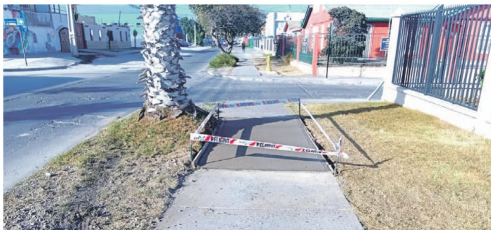
El municipio de Coquimbo está reparando las veredas en el sector de Sindempart donde están deterioradas, levantadas por las raíces de los árboles o por sismos.
